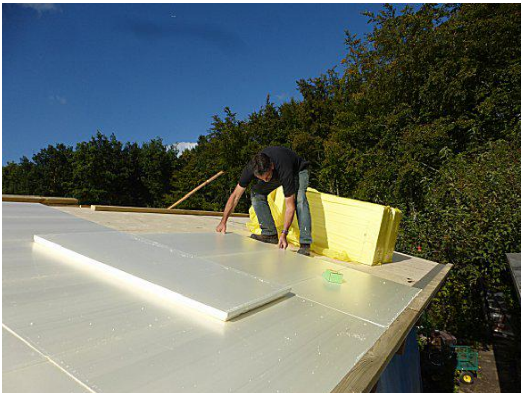
Isolatie is aan buitenzijde aangebracht op dakplaten. Aan onderzijde van dakplaten eerst een strook betumen van 15cm, aan de randen een balk geïmpregneerd vuren om isolatieplaten eenvoudig te fixeren. Isolatieplaten 45mm dikte.
